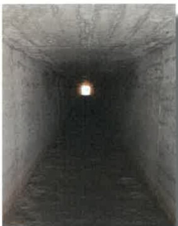
Cunicolo scatolare con fondo lastricato in pietra, elevazioni e soletta in calcestruzzo faccia vista
