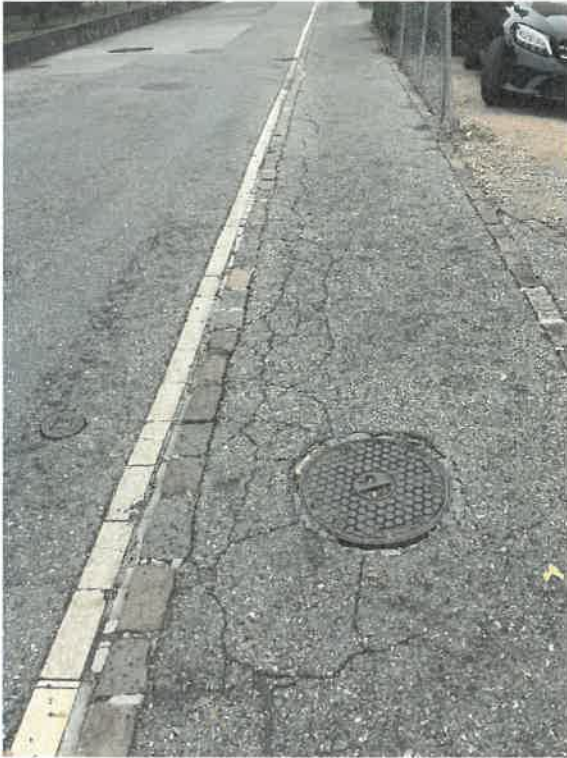
Foto 5: Tratto di marciapiede con fessure.
