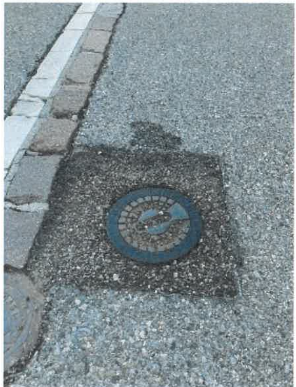
Foto 8: Rappezzo per nuovo chiusino non a filo del manto adiacente.
