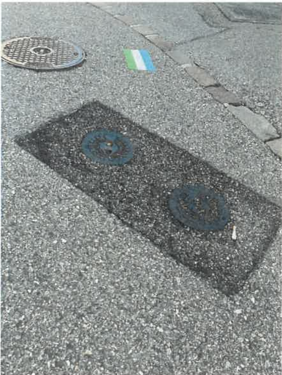
Foto 7: Rappezzo per nuovi chiusini non a filo del manto adiacente.
