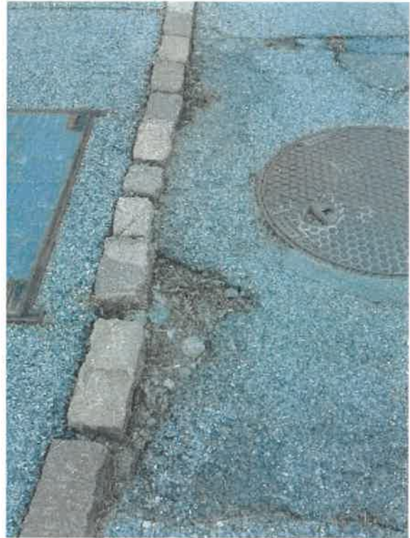
Foto 6: Tratto di marciapiede senza più asfalto.
