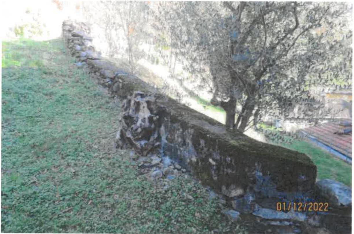
Foto 1 – I primi 5 metri di muro, in passato sistemati con del calcestruzzo.
